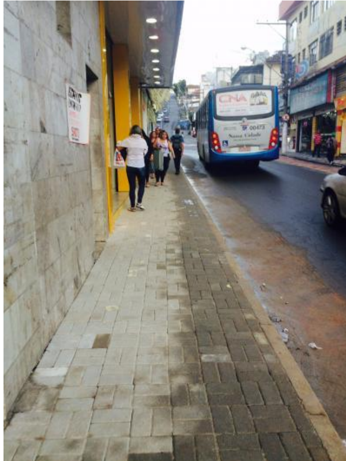
Figura 4: Calçada em Franco da Rocha em reforma. Além dos pisos, grande parte necessita de alargamento, acessibilidade e sinalização adequada.
